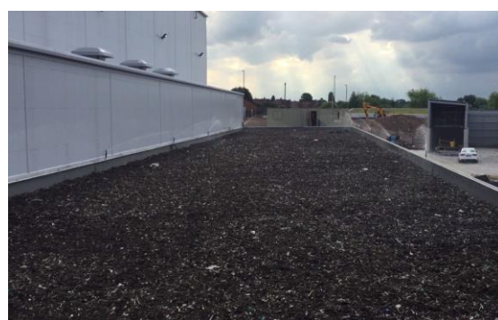
(3) BIOFILTRO PER ABBATTERE GLI ODORI DEL PROCESSO
